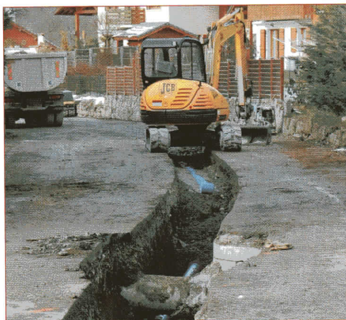
Réseau d'assainissement à Brégny
